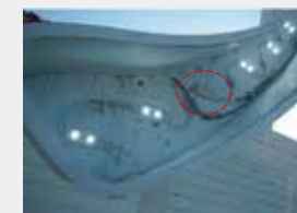
水の浸水により故障した100Vモジュール
